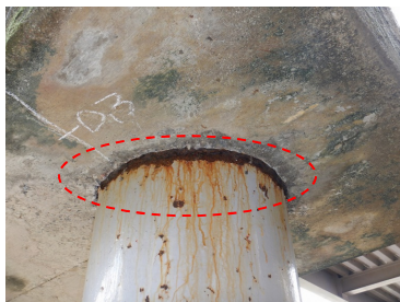
鋼材の腐食状況
