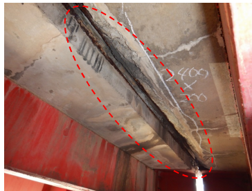
床版の剥落状況
