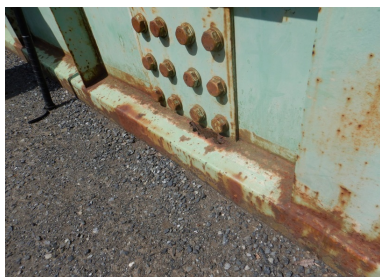
塗装の劣化状況
