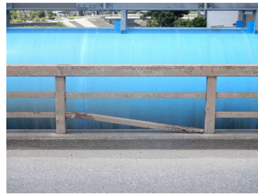
防護柵の変形・欠損状況
