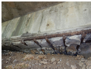
鉄筋露出状況
