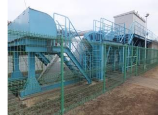
浜崎排水機場
