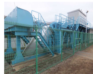
浜崎排水機場
