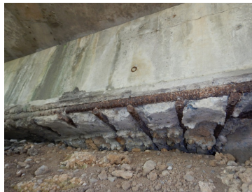
鉄筋露出状況
