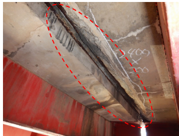
床版の剥落状況
