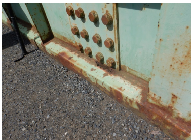
塗装の劣化状況
