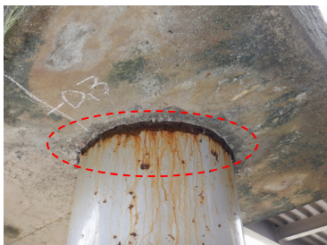
鋼材の腐食状況
