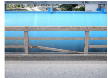
防護柵の変形・欠損状況
