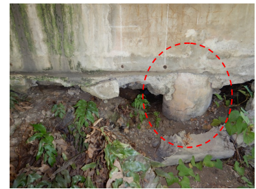
基礎の露出状況
