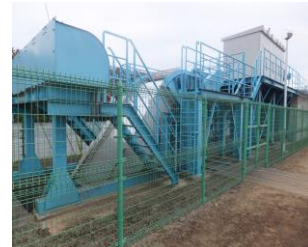
浜崎排水機場
