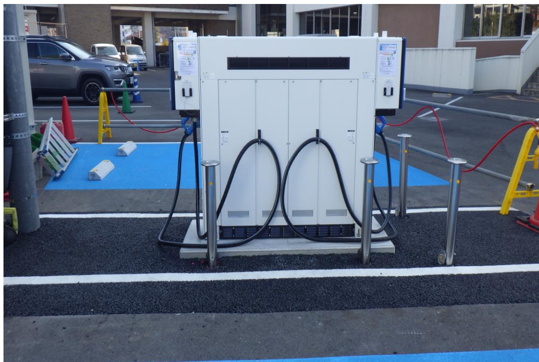
市役所公用車駐車場に設置の電気自動車急速充電器 詳しくは43ページ参照
