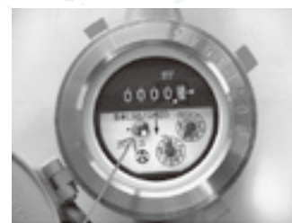
水道メーター
