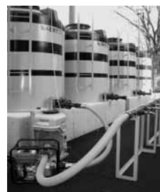
第10号取水井 応急給水設備
