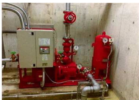
〈更新後の消火ポンプ〉
