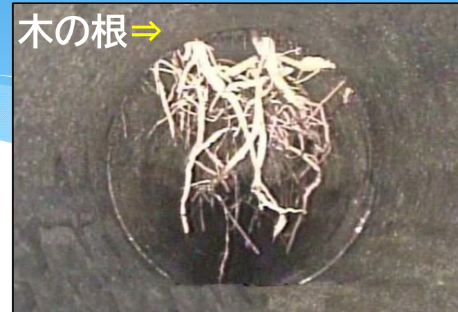
管内に木の根が浸入（管閉塞の原因）
