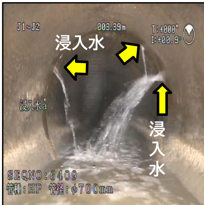
汚水本管の管接続部からの浸入水
