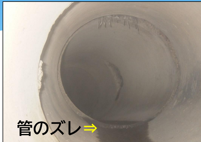
管のズレ（道路陥没の原因）
