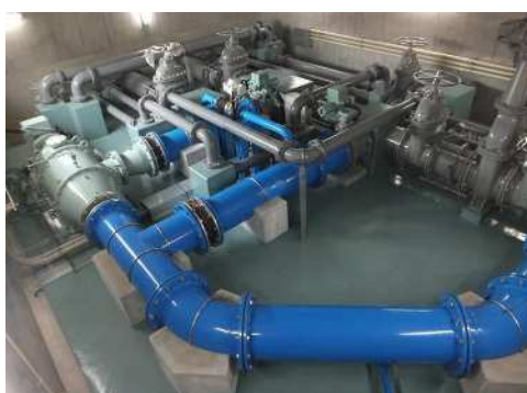
泉水浄水場着水井配管室
