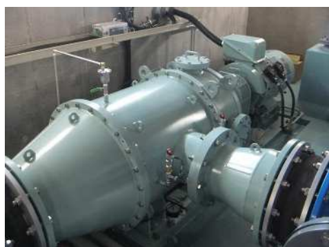
泉水発電所水車発電機
