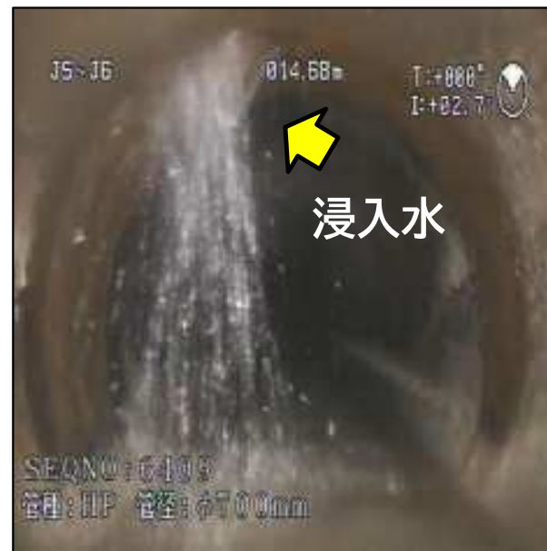
生活水を排水させるための取付管と汚水本管の接続部からの浸入水
