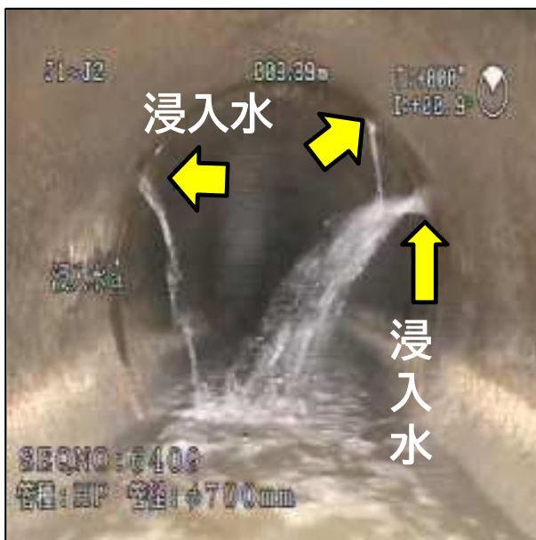
汚水本管の管接続部からの浸入水
