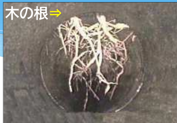
管内に木の根が浸入（管閉塞の原因）
