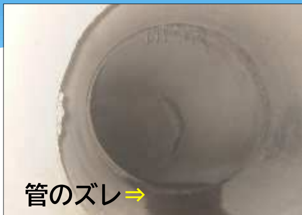
管のズレ（道路陥没の原因）
