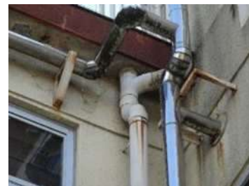
配管接合部の劣化
