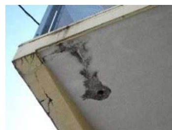
コンクリートの劣化
