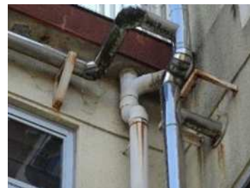
配管接合部の劣化
