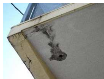
コンクリートの劣化
