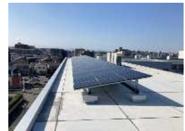
太陽光発電設備
