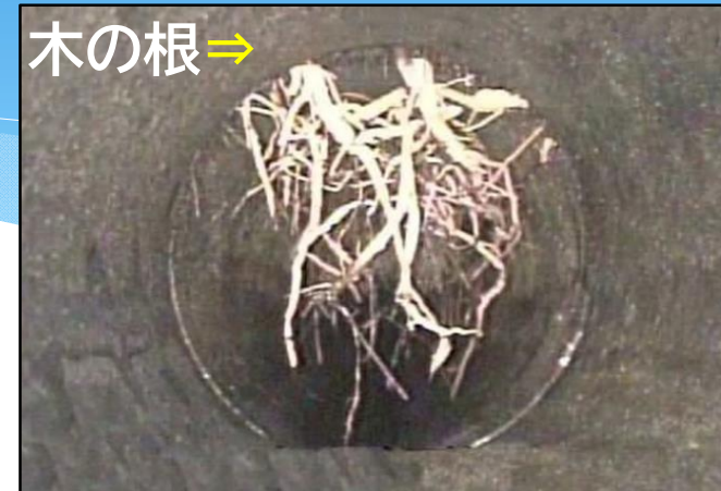
管内に木の根が浸入（管閉塞の原因）
