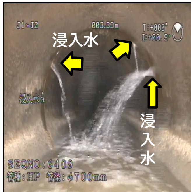
汚水本管の管接続部からの浸入水
