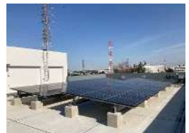
太陽光発電設備
