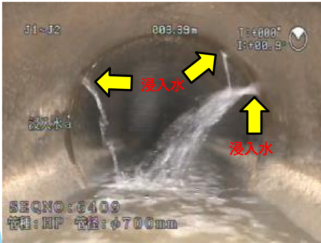
汚水本管 HP管（ヒューム管）内径700mm 汚水本管の管接続部からの浸入水
