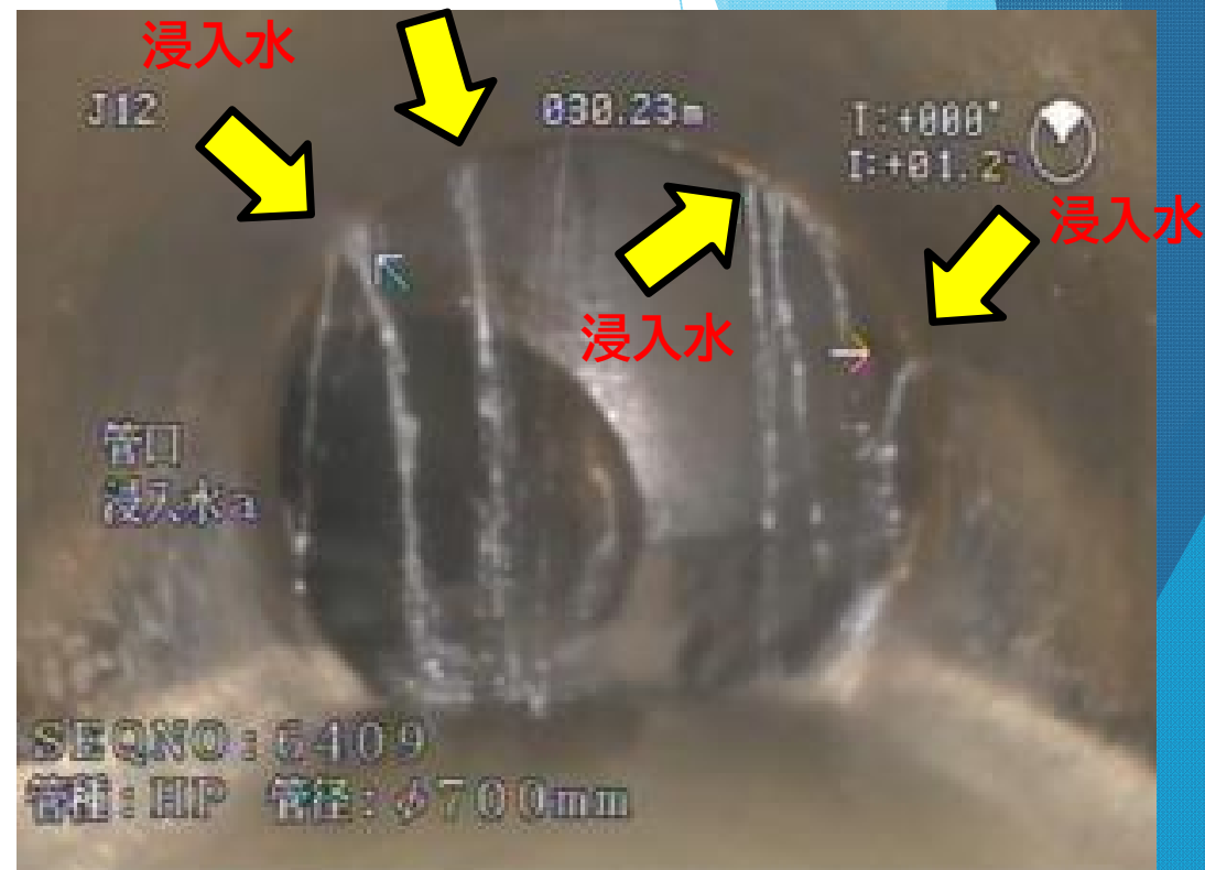
汚水管 HP管（ヒューム管）内径700mm 汚水本管の管接続部からの浸入水
