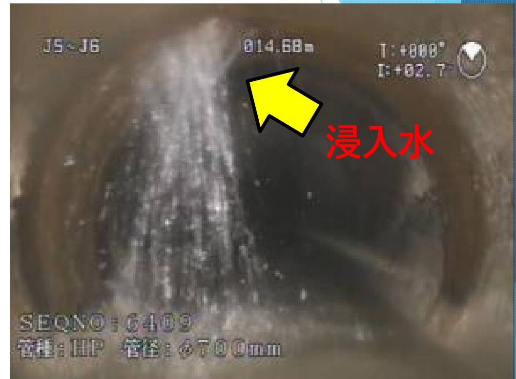
汚水本管 HP管（ヒューム管）内径700mm 生活水を排水させるための取付管と汚水本管の接続部からの浸入水
