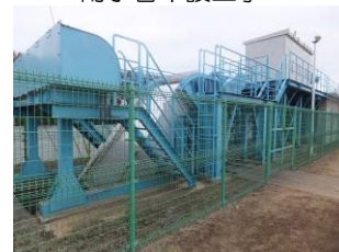
浜崎排水機場
